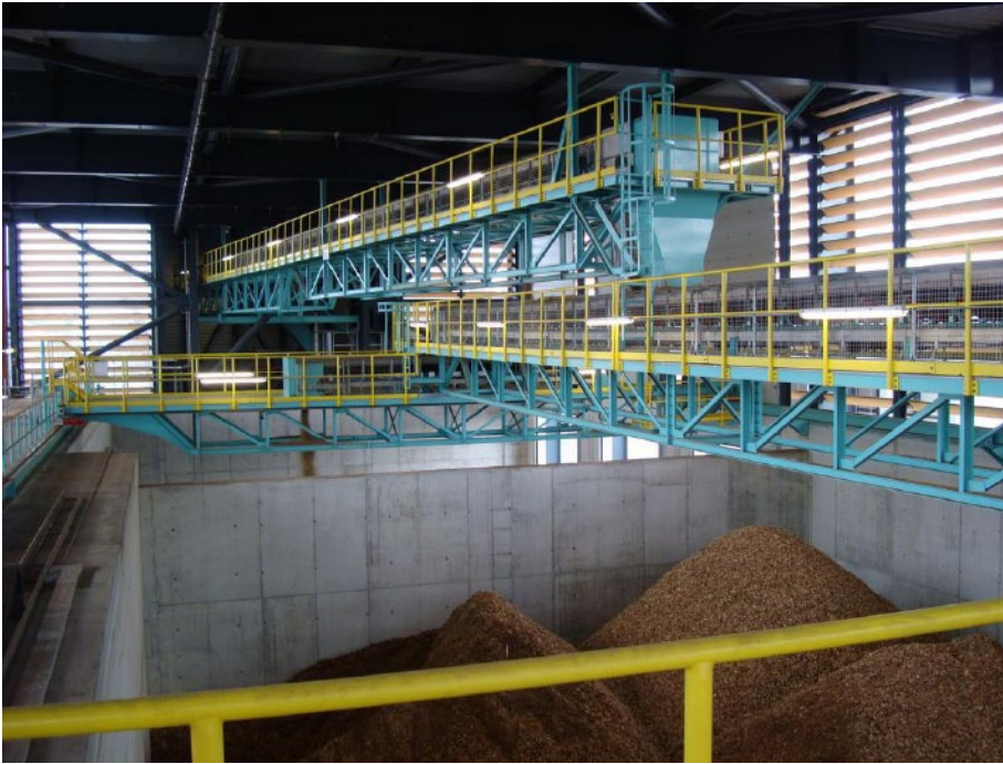
Die Lagerhalle mit einer Kapazität von rund 7000 m 3 besteht aus fünf Lager- sowie drei Reservebunkern.
